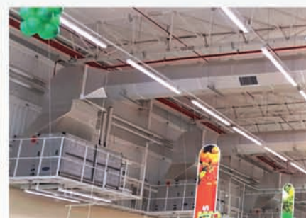
Instalação Atacadão, Patos - PB
