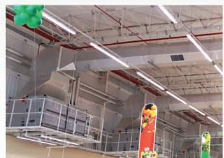
Instalação Atacadão, Patos - PB
