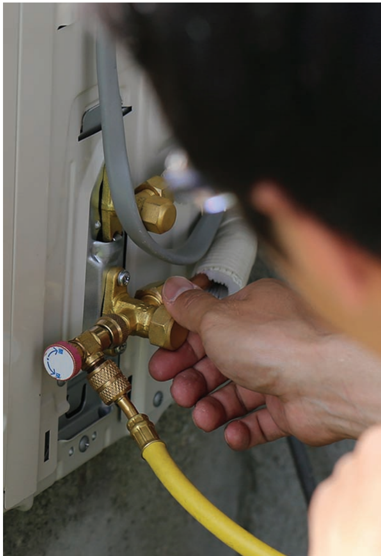
Estado de conservação dos componentes dos sistemas de HVAC-R influi diretamente no surgimento de pontos de fuga de fluidos frigoríficos
