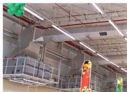
Instalação Atacadão, Patos - PB
