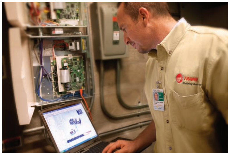
Fabricantes como a Trane têm mesclado o sistema de controle com o gerenciamento de manutenção para um melhor controle preditivo
